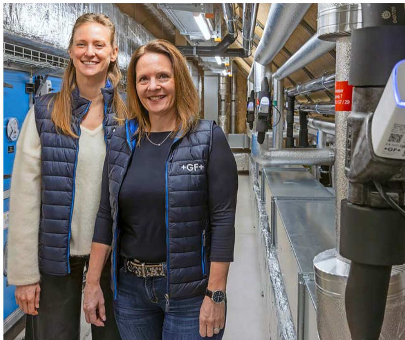
Freuen sich über die Gebäudetechnik im neuen Hotel 1802: Jil Kropf (l.), Geschäftsführerin Klostersgut Paradis, und GF-Immobilienchefin Susanne Eigenheer. BILDER GF
