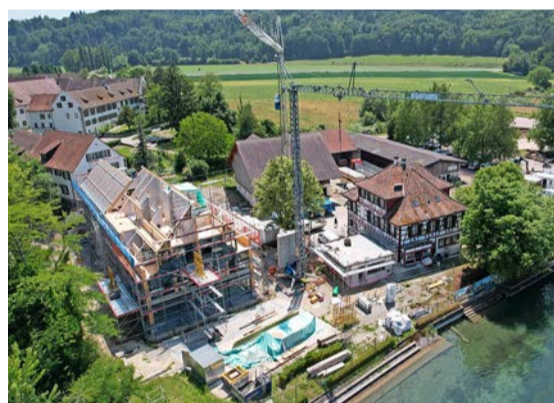
Die brandschutzrelevanten Teile des Hotels sind aus Beton, alles andere ist aus Holz.
